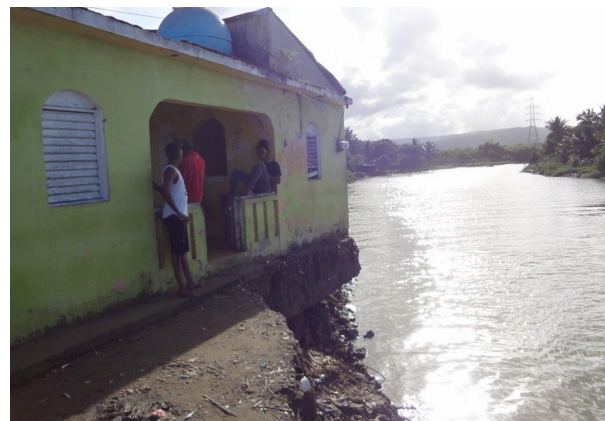
Imagen II. Erosión cimientos vivienda provocada por el río San Marcos
