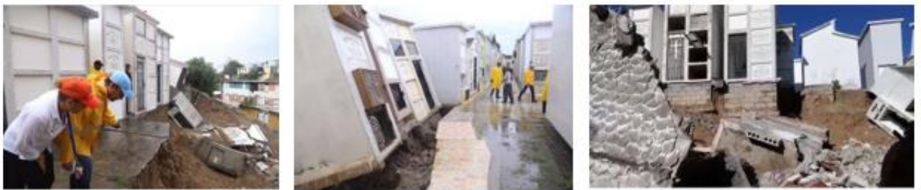
Figura 11: Deslizamientos de tierra y derrumbes de nichos en el Cementerio Municipal de la Calle 30 de Marzo luego del paso del Huracán María. Septiembre 2017. Fuentes: (Minalla, 2017)
